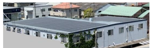
写真 本社屋上 太陽光パネル
