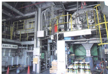
自社設計により1976年より操業する本社第一工場の焼却炉
